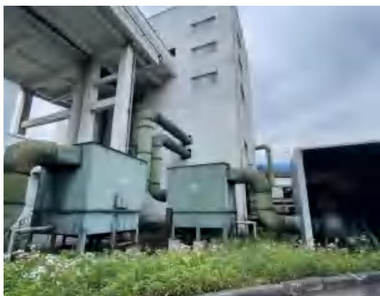
水力冲击式除尘器及地面排放口
