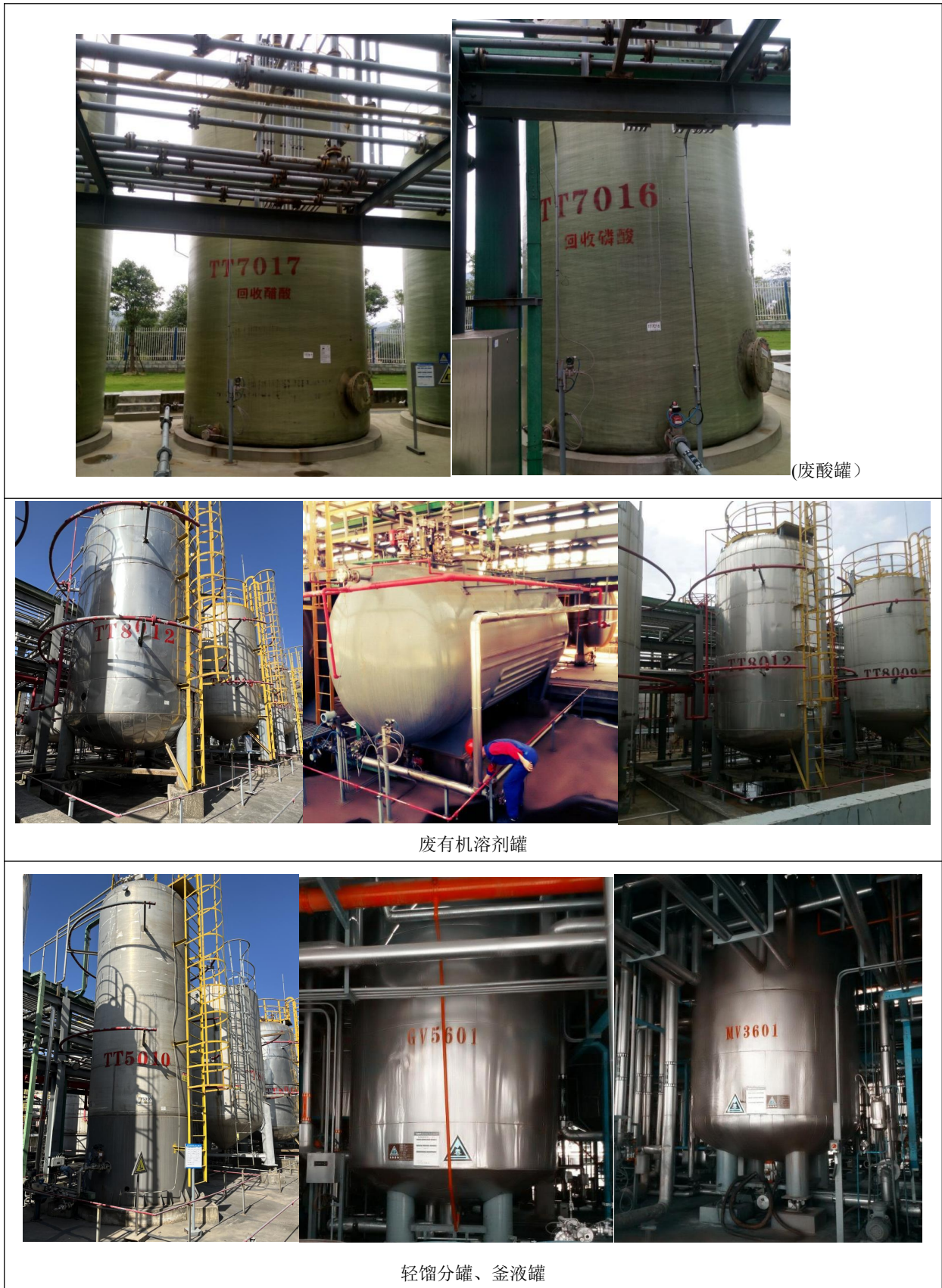
图3.5.3-1危废暂存设施现场照片
