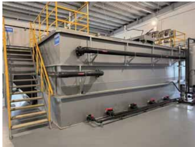
图 3-3 污水处理设施照片
