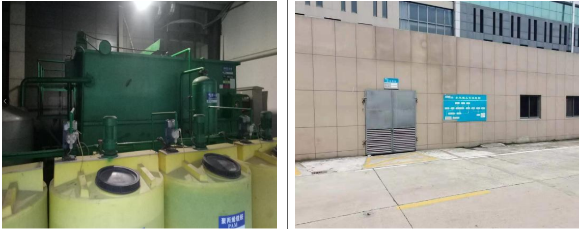
图 3-6 污水处理设施照片
