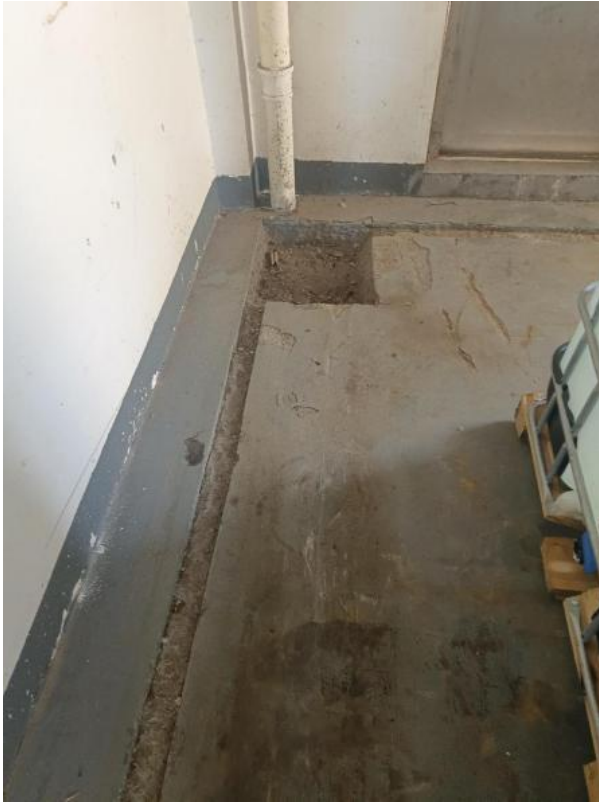
危废仓库集液池和导流沟
