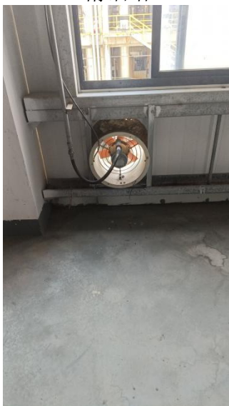
事故状态下开启的风机（柔性安装）
