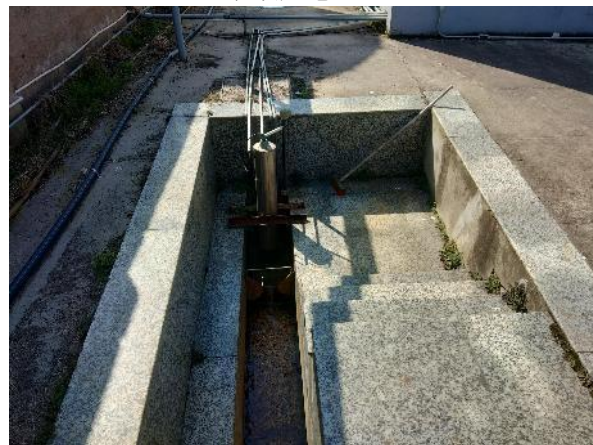
废水总排放口
