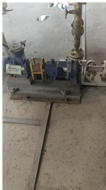
机泵（联轴器内设减震块）
