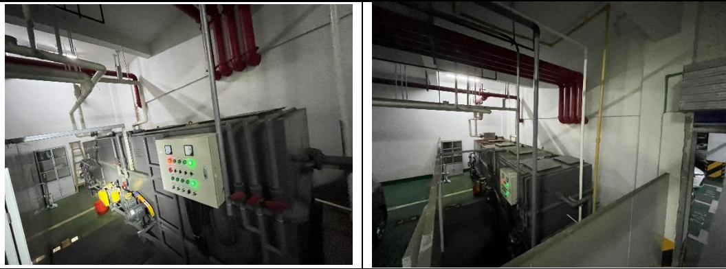
浙江迪赛思诊断技术有限公司污水处理设施
